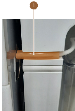
รูป 50: สายจ่ายน้ำในหน่วยทำความเย็น
